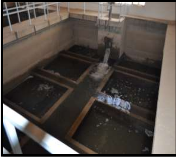
صورة (٨) احد احواض الفلترة من الداخل في مشروع ماء الرمادي الكبير
