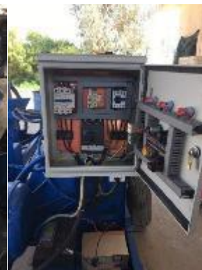
(d) Control Panel
